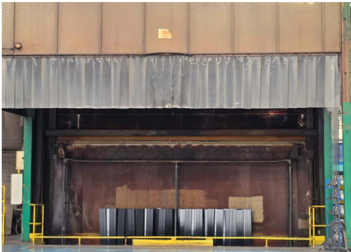
Figura 22: Bandelle in uscita impianto cataforesi
